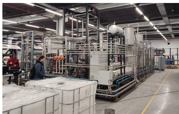
Vista general de la planta piloto del ICP durante su fase final de montaje.
