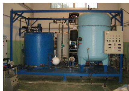
Digestor anaerobio para producción de biogás.
